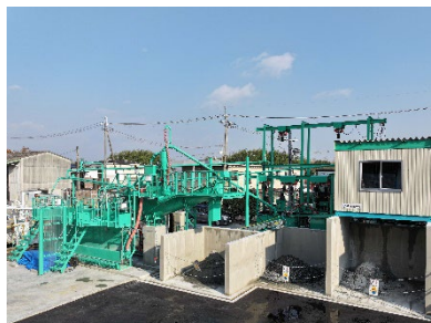
排水処理設備
