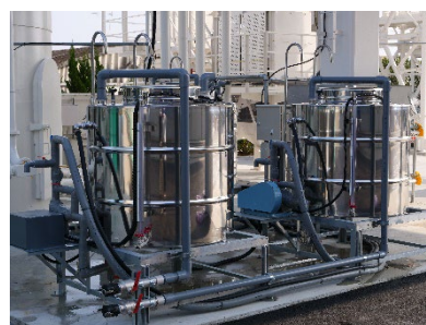
混和剤用タンク
